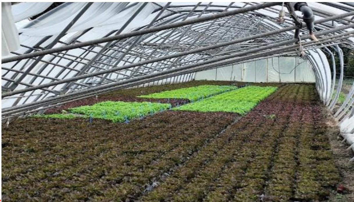
Figure 2 : effondrement du tunnel le 12/02/2026
